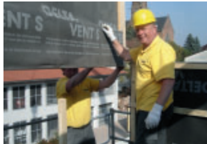
Der Einbau von Leichtbau-Trennwänden bietet flexible Gestaltungsvarianten, wie beim Bau dieses Bürogebäudes in Eisenberg. (Quelle NUSSER)
